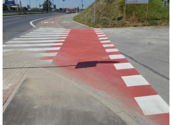
Rysunek 17. Zniwelowane krawężniki na przejeździe rowerowym, Nowiny
