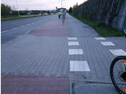
Rysunek 24. Kielce, ul. Krakowska, DDR po złej stronie względem chodnika, brak zachowania nawierzchni i niwelety na wyjeździe z posesji
