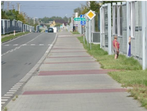
Rysunek 14. Sielcia - Końskie - brak zachowania niwelety na wyjazdach z posesji, tzw. „fale Dunaju”
