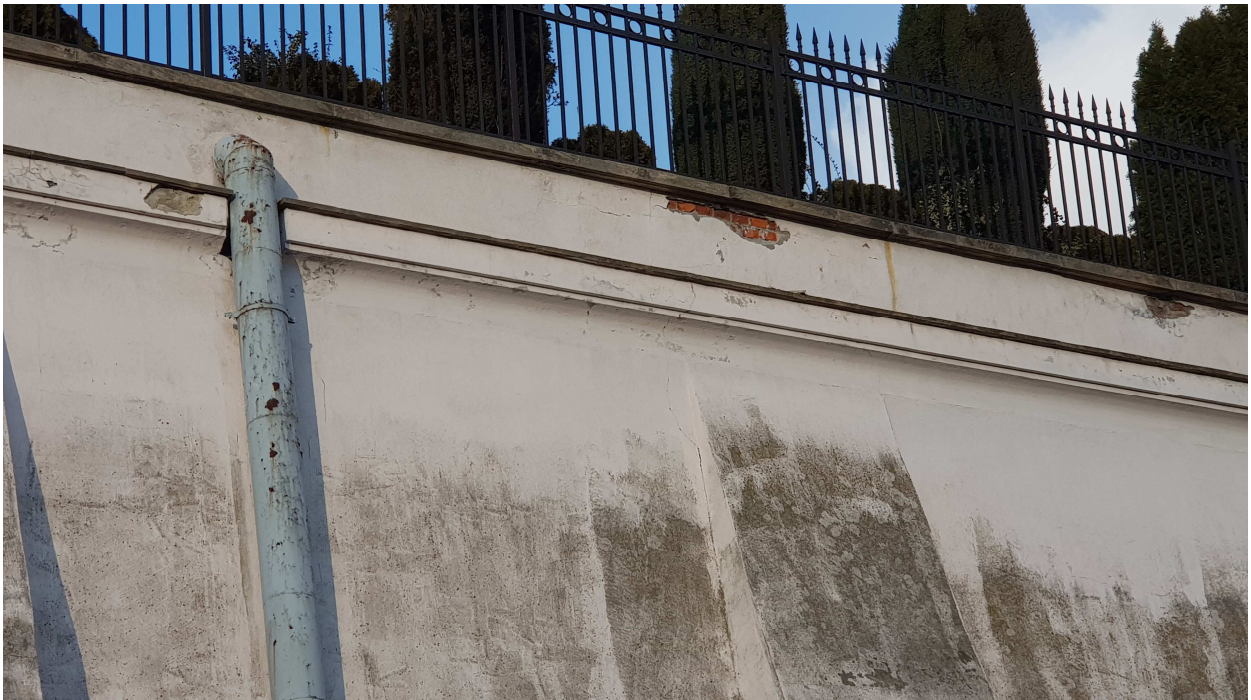
fot. Nr 10 Widok zniszczonej rury spustowej, uszkodzonych i zdegradowanych tynków.
