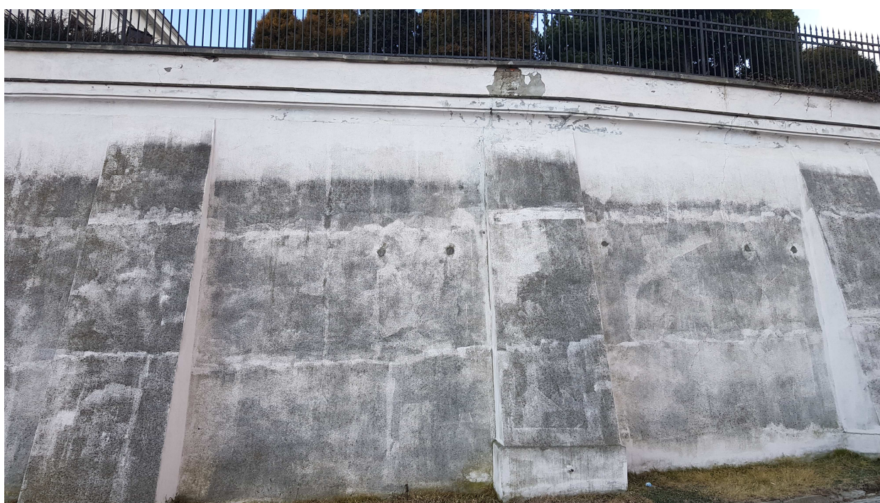
fot. Nr 8 Korozja biologiczna okładzin tynkarskich muru i odspojone tynki.
