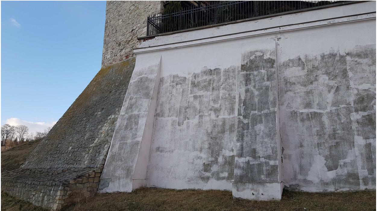
fot. Nr 9 Widok końcowej części muru tynkowanego - zdegradowane i uszkodzone tynki oraz korozja biologiczna.
