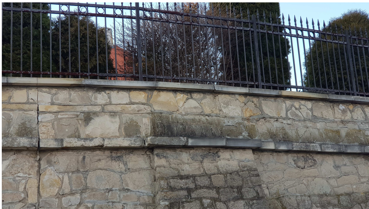
fot. Nr 13 Widok skorodowanego ogrodzenia.
