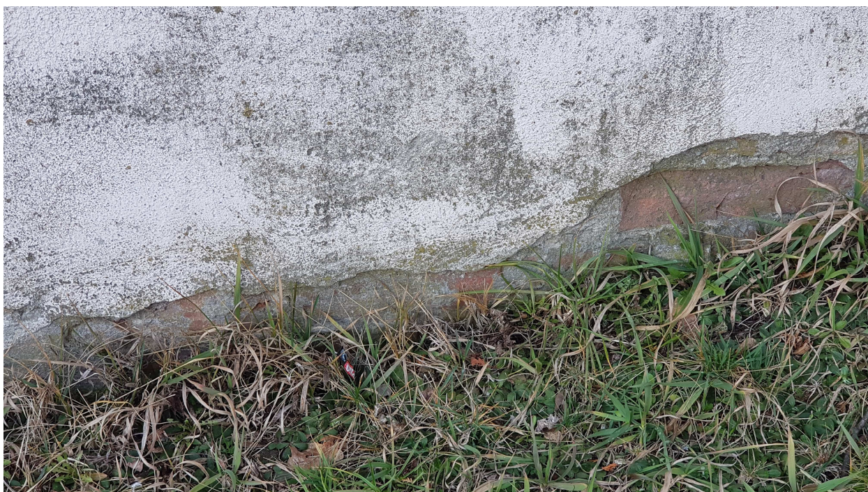
fot. Nr 12 Widok odspojonych tynków cokołu.
