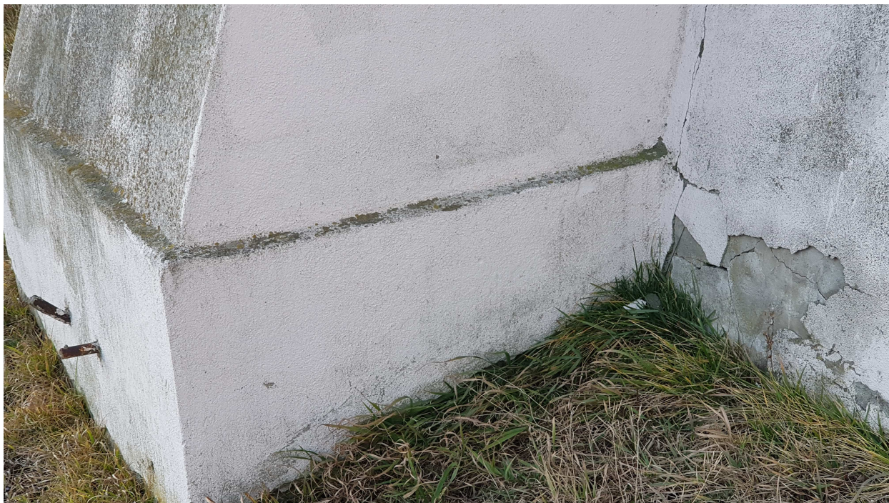
fot. Nr 11 Uszkodzone tynki w części cokołowej.
