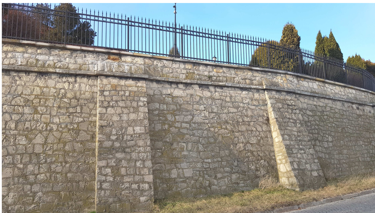
fot. Nr 5 Faktura kamiennego muru z piaskowca - korozja biologiczna.
