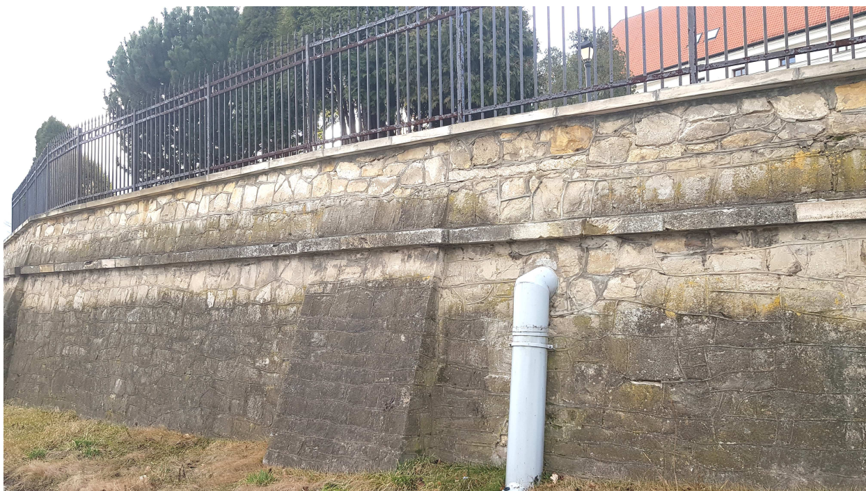
fot. Nr 4 Korozja biologiczna na powierzchni piaskowca muru z kamienia.
