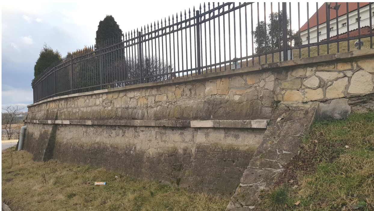
fot. Nr 3 Widok początkowego fragmentu muru – korozja biologiczna i uszkodzone kamienne okładziny.
