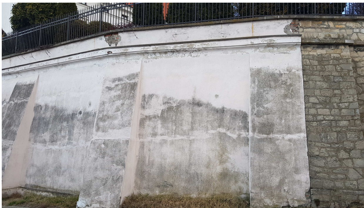
fot. Nr 7 Widok początkowego odcinka muru tynkowanego –korozja biologiczna tynku.
