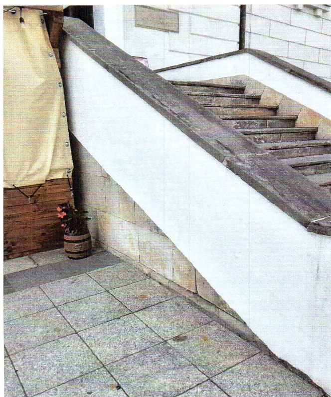
fot. Nr 6 Widok schodów wejścia głównego – zdegradowane i uszkodzone tynki murków bocznych.
