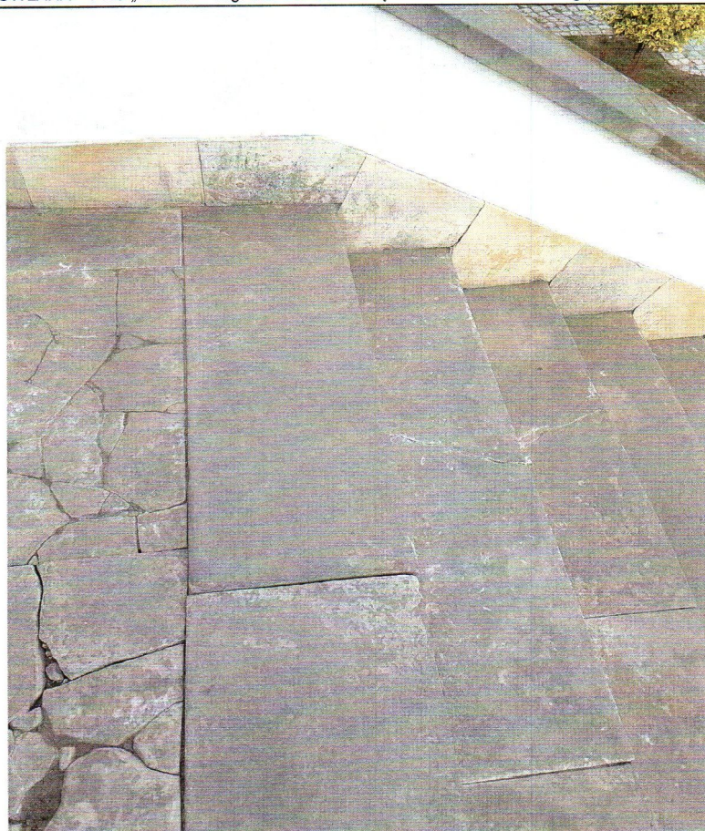
fot. Nr 3 Widok spocznika wejścia głównego – popękane i uszkodzone płyty kamienne okładziny.
