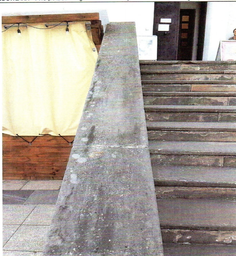
fot. Nr 5 Okładzina murków bocznych – zabrudzone płyty kamienne okładziny.
