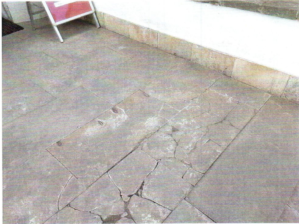
fot. Nr 1 Widok spocznika wejścia głównego – popękane i uszkodzone płyty kamienne okładziny.
