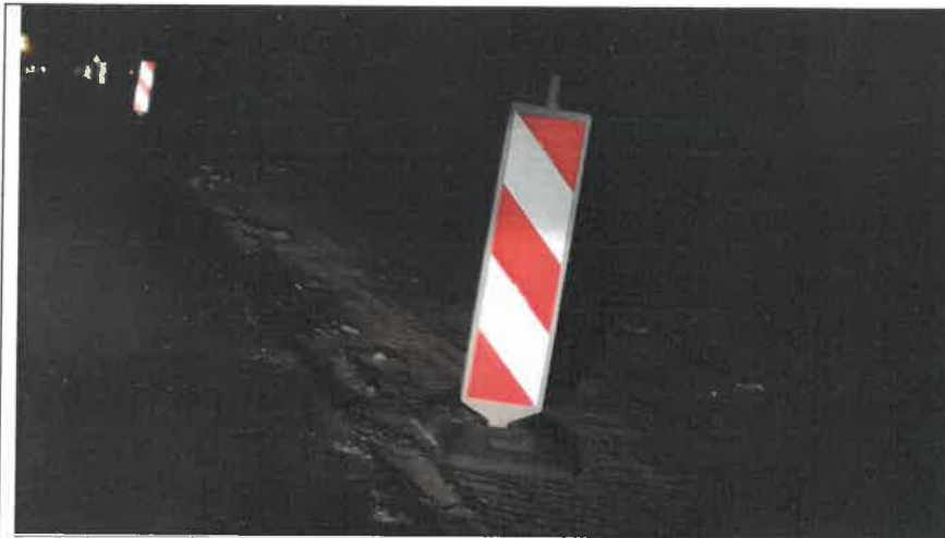
Fot. nr 4. DW 728. Niewłaściwa tablica prowadząca na poboczu drogi. Skosy tablicy prowadzą poza teren jezdni.
