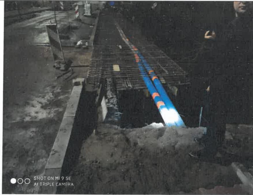
Fot. nr 8. Pozostawione wykopy otwarte bez należytego zastosowania urządzeń bezpieczeństw a ruchu, przy jednoczesnym umożliwieniu poruszania się pieszych przez teren budowy.
