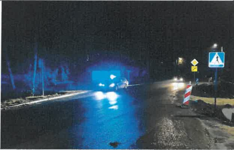
Fot. nr 3. DW 748. Istniejący znak D-6 zgodnie z założeniami projektu tymczasowej organizacji ruchu winien być odkręcony lub zasłonięty z uwagi na brak oznakowania poziomego.
