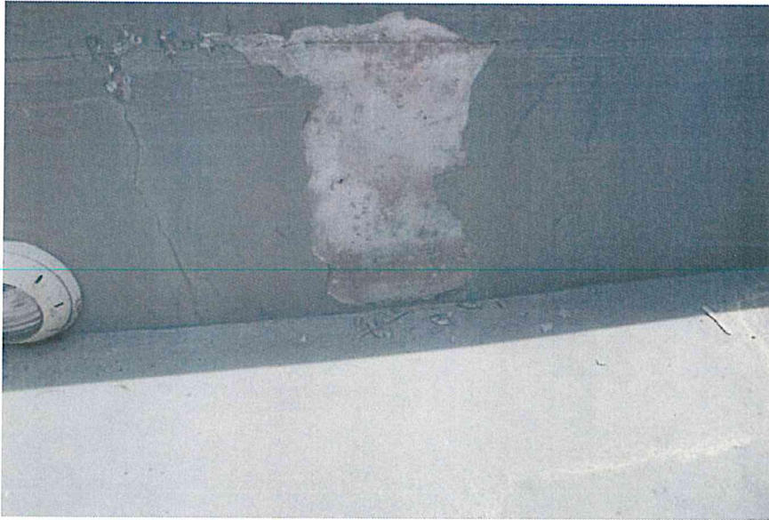
Fot. 1 Spękania i odspojone warstwy na ścianie zbiornika
