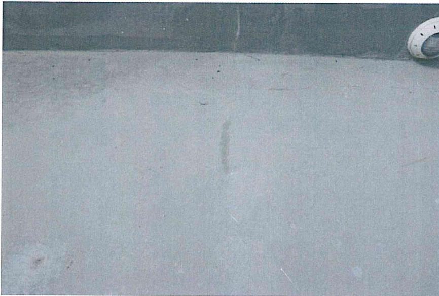
Fot. 2 Spękania w dnie zbiornika
