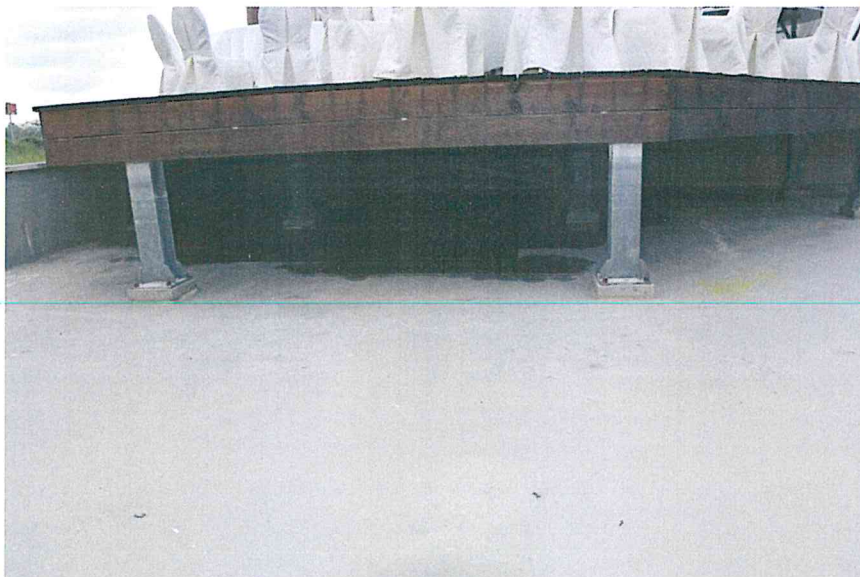
Fot. 5 Zastoiny wody pod drewnianym podestem
