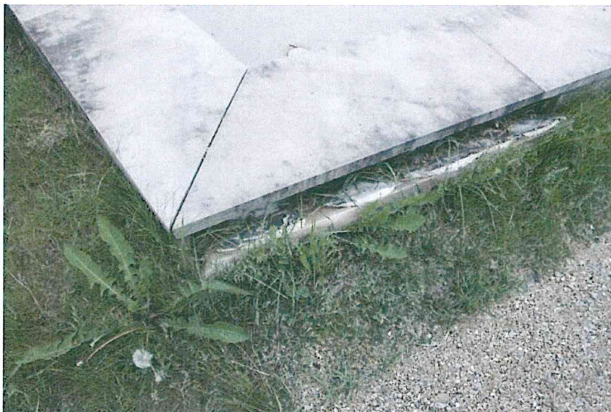
Fot. 8 Okładzina z piaskowca przeklejona pierwotnie na „placki” zaprawy
