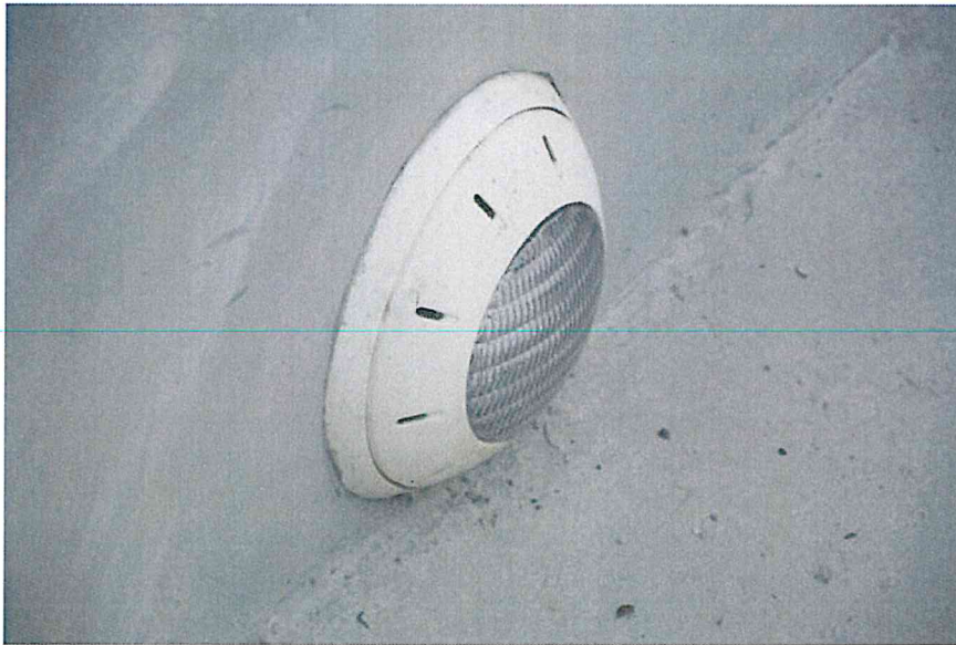
Fot. 7 Oprawa oświetlenia
