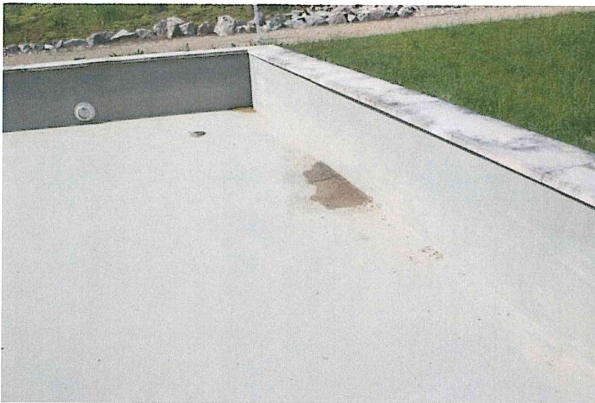
Fot. 4 Zastoiny wody świadczące o niewłaściwym spadku
