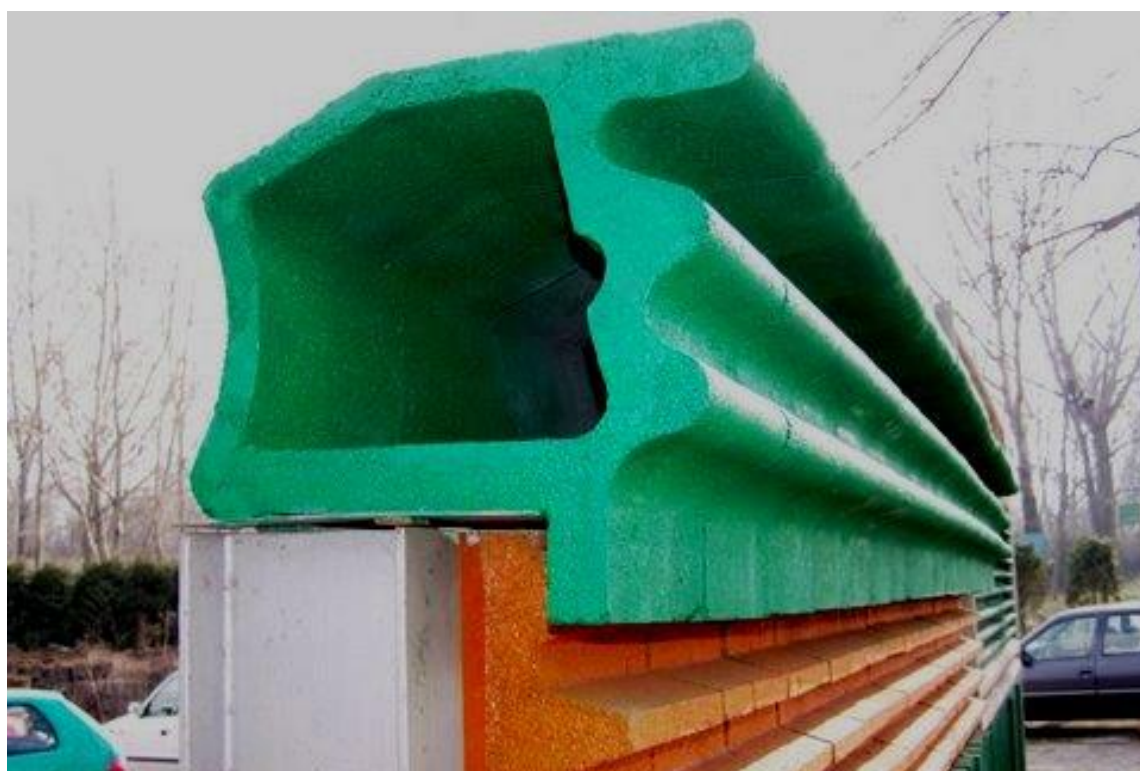
Rysunek 12-9 Dyfraktor zamontowany na krawędzi górnej ekranu akustycznego
