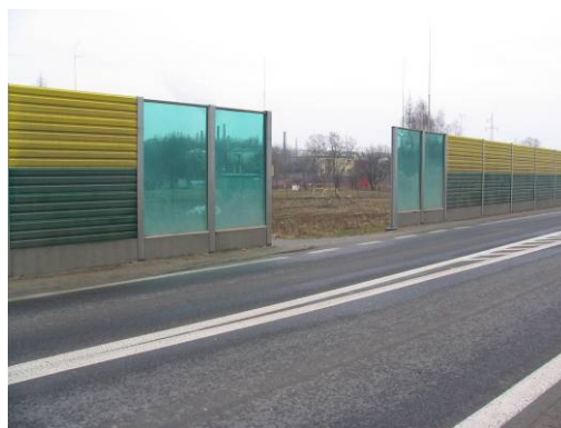
Fot. 7.2. Konieczność zapewnienia zjazdu do posesji – przerwanie ciągłości ekranu akustycznego i słaba jego skuteczność
