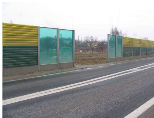
Fot. 7.2. Koniczność zapewnienia zjazdu do posesji – przerwanie ciągłości ekranu akustycznego i słaba jego skuteczność
