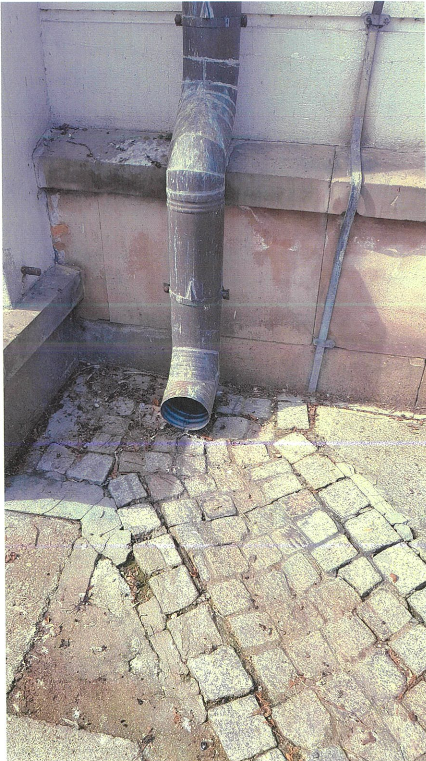
fot. Nr 4 Korozja biologiczna części cokołowej i widok systemu odwodnienia .
