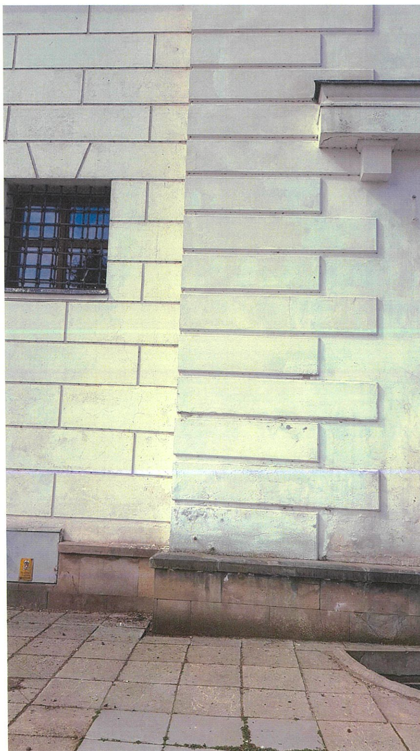
fot. Nr 5 Faktura tynkarska w elewacji frontowej - korozja biologiczna.
