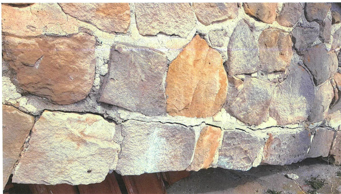
fot. Nr 10 Kamienny cokół przy baszcie od strony południowej.
