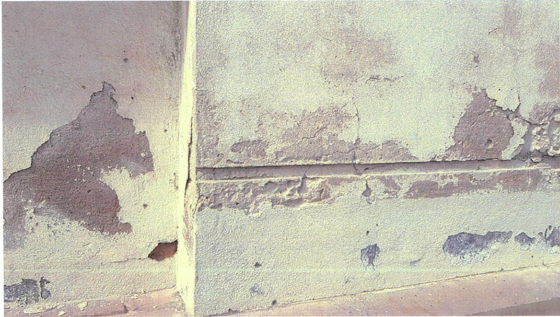
fot. Nr 1 Widok degradacji wypraw tynkarskich z elementami biniowania.
